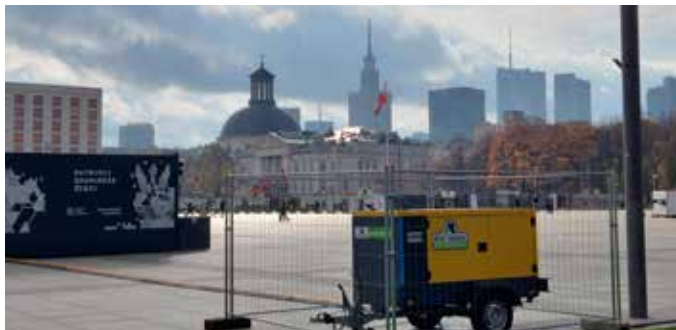
Jezdny agregat prądowłórczy na Placu Piłsudskiego w Warszawie, 2022
